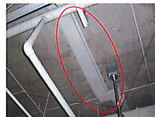
【漏水対策：地下2階天井】
