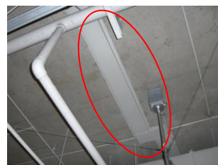
【漏水対策：地下2階天井】
