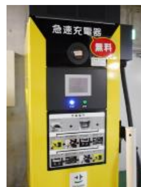
図 整備した EV 車急速充電器
