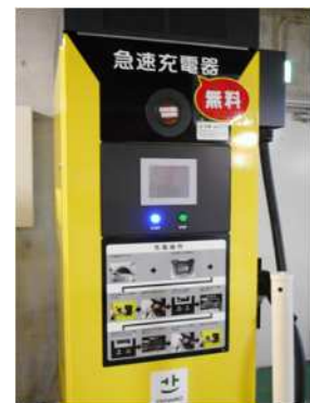
図 整備した EV 車急速充電器
