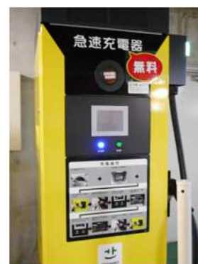
図 整備した EV 車急速充電器
