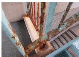
塩害による錆
