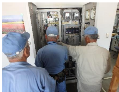
電気設備保守点検
