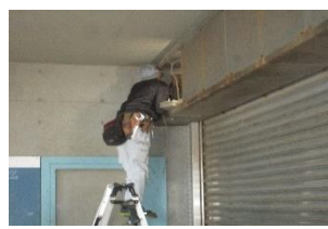
シャッター定期点検
