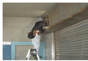
シャッター定期点検
